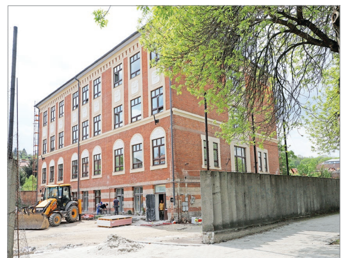
A főhomlokzatot takaró állványzatot az elmúlt napokban már lebontották. Fotó: Mocsári László
